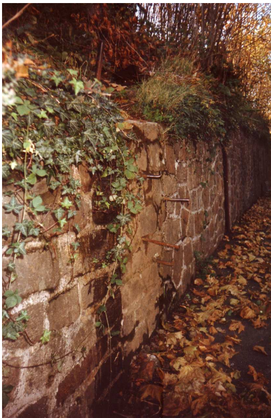
En face du siège du B.R.O., planté entre les pierres, quatre gros pitons permettant d'accéder aux voies du chemin de fer P.O.C.(Paris-Orléans-Corrèze) et du PO (Paris-Orléans)
